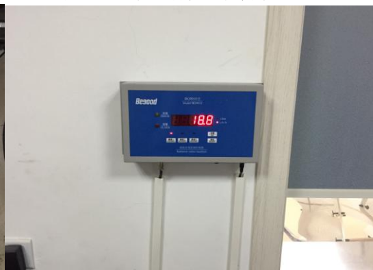
图6-7 机房在线监测系统
